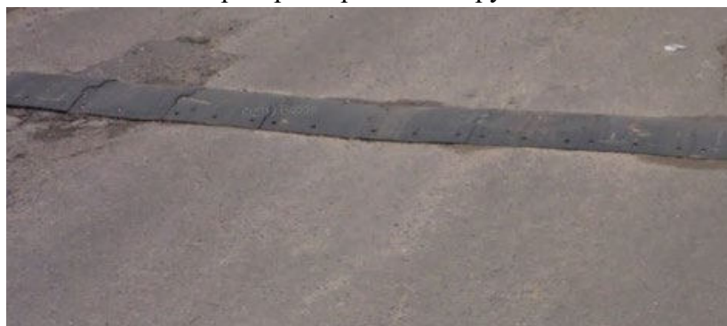
Рисунок 1.7.5. Пример неудовлетворительного состояния искусственной неровности сборно-разборной конструкции
