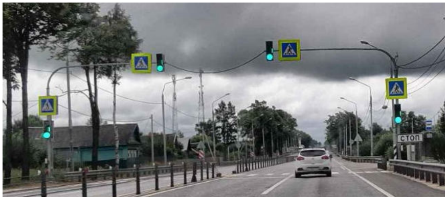
Рисунок 1.7.1. Пример эксплуатационного состояния светофоров Т.1, П.1, расположенных на федеральной автомагистрали М-10 «Россия»
